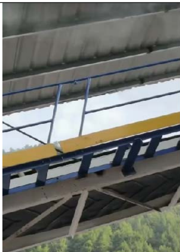
密闭输送带及加盖顶棚
