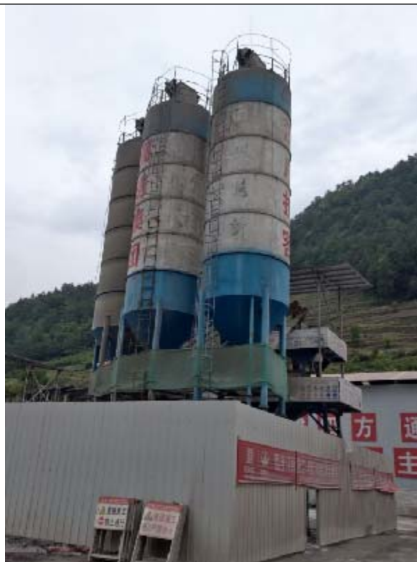
封闭厂房、粉料筒仓布袋除尘器
