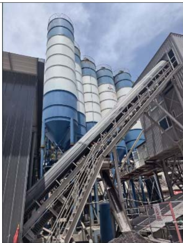
封闭厂房、粉料筒仓布袋除尘器
